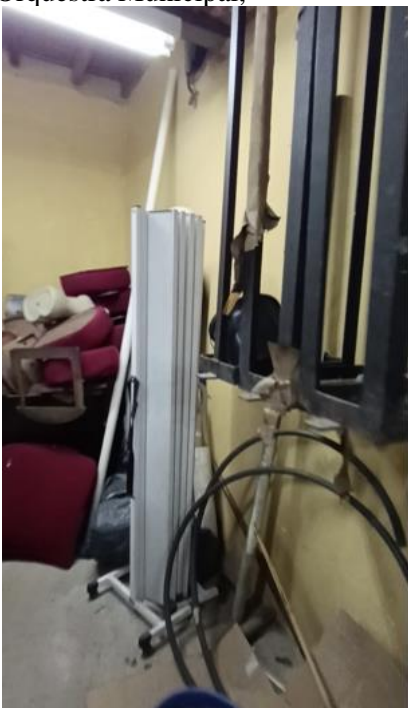
Peças de poltrona, estofados, etc empilhados indevidamente, juntamente com material inflamável, documentos, instrumentos da Orquestra e rede elétrica mal isolada.
