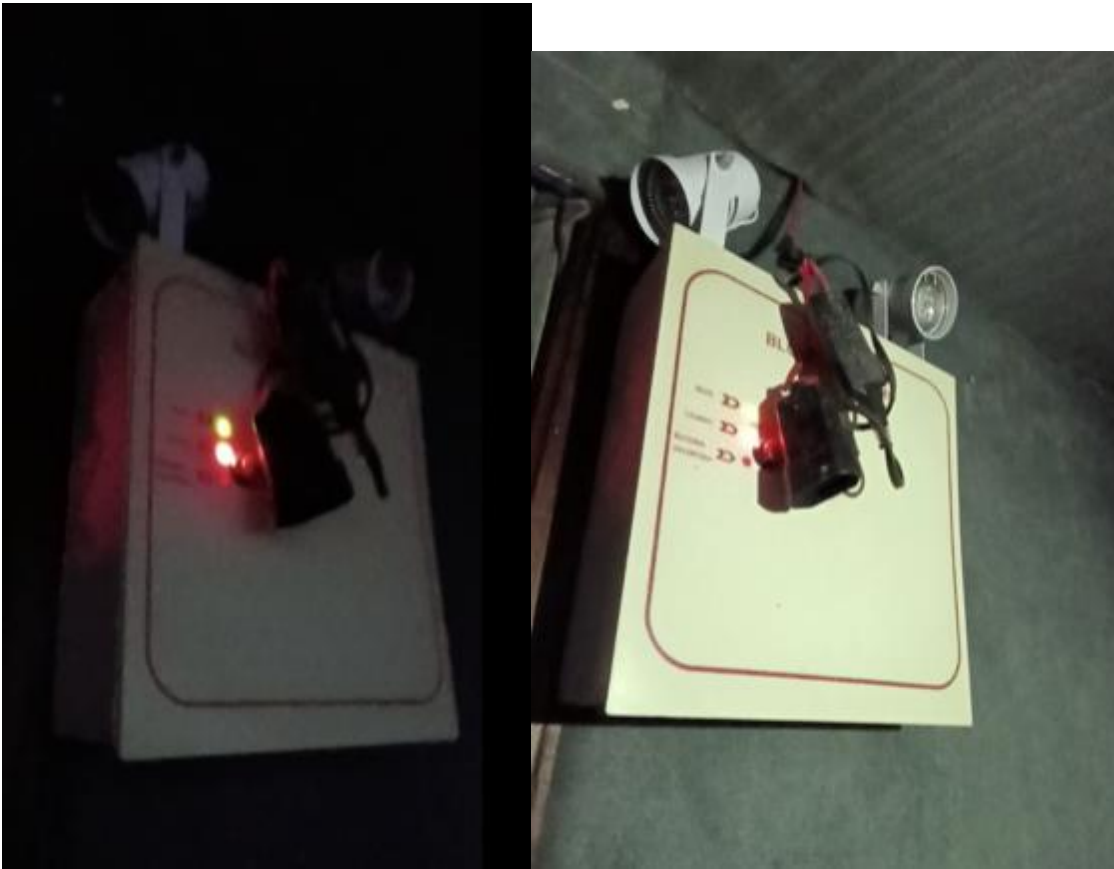
Iluminação de emergência na plateia: fios soltos, aglomerados
