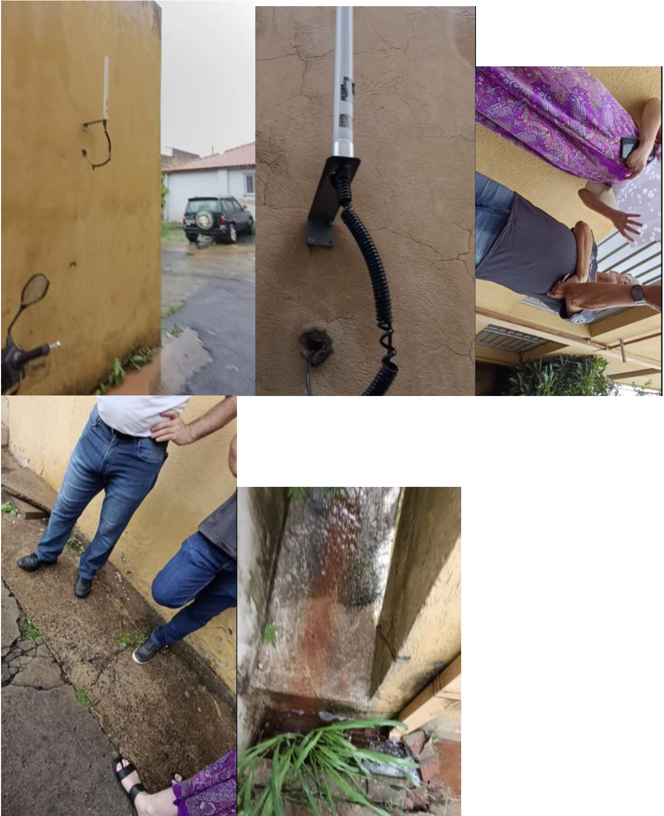
Sistema da cabine elétrica danificado. Piso com infiltrações, mato crescendo no entorno da cabine elétrica
