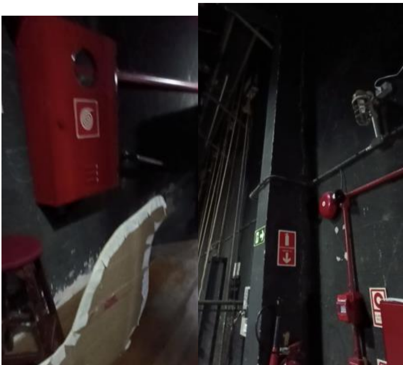
Fios enrolados nos extintores e obstruções nos hidrantes. Falta de lâmpadas no local. Acúmulo de sujeira
