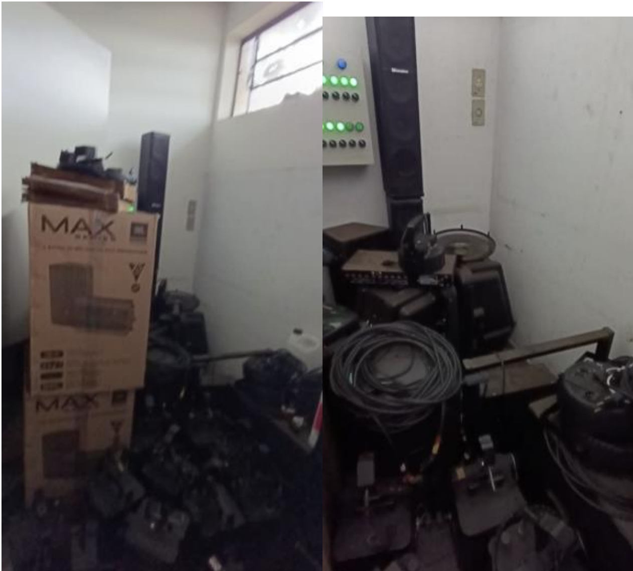
Material empoeirado demonstrando que está há muito tempo armazenado incorretamente nesse local Material empilhado desordenadamente na sala de dimers e no entorno do quadro de elétrica
