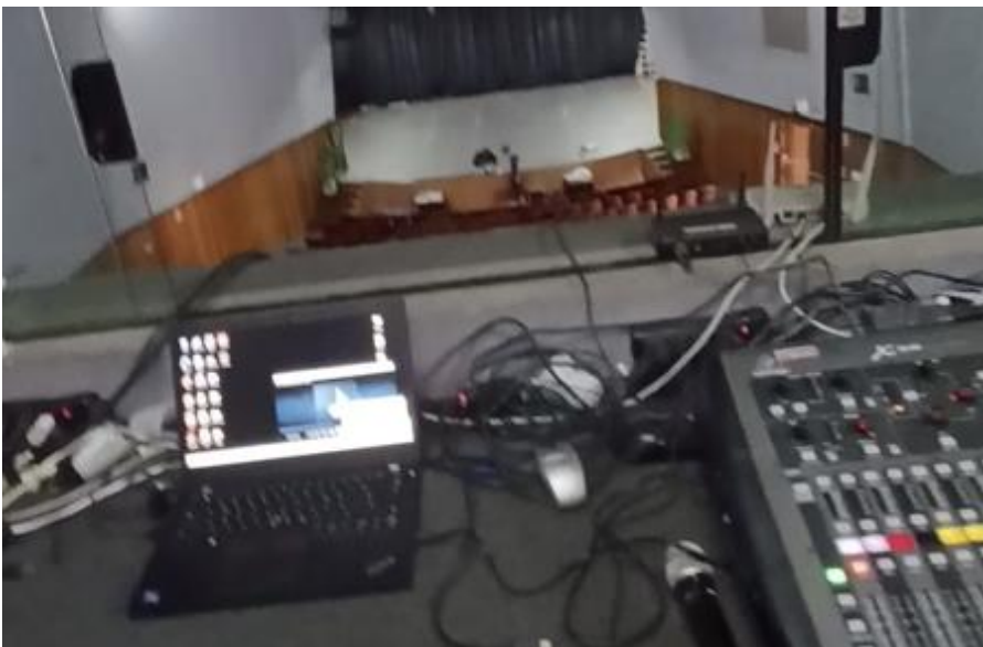
Uso de benjamins, extensões mal feitas, fios soltos, acúmulos de fiações, fios soltos sobre tecido da bancada, carpete da bancada sem ignifugação (sem proteção contra incêndio), fios soltos para todos os lados sem identificação. Riscos iminentes, risco de choque, risco de incêndio
