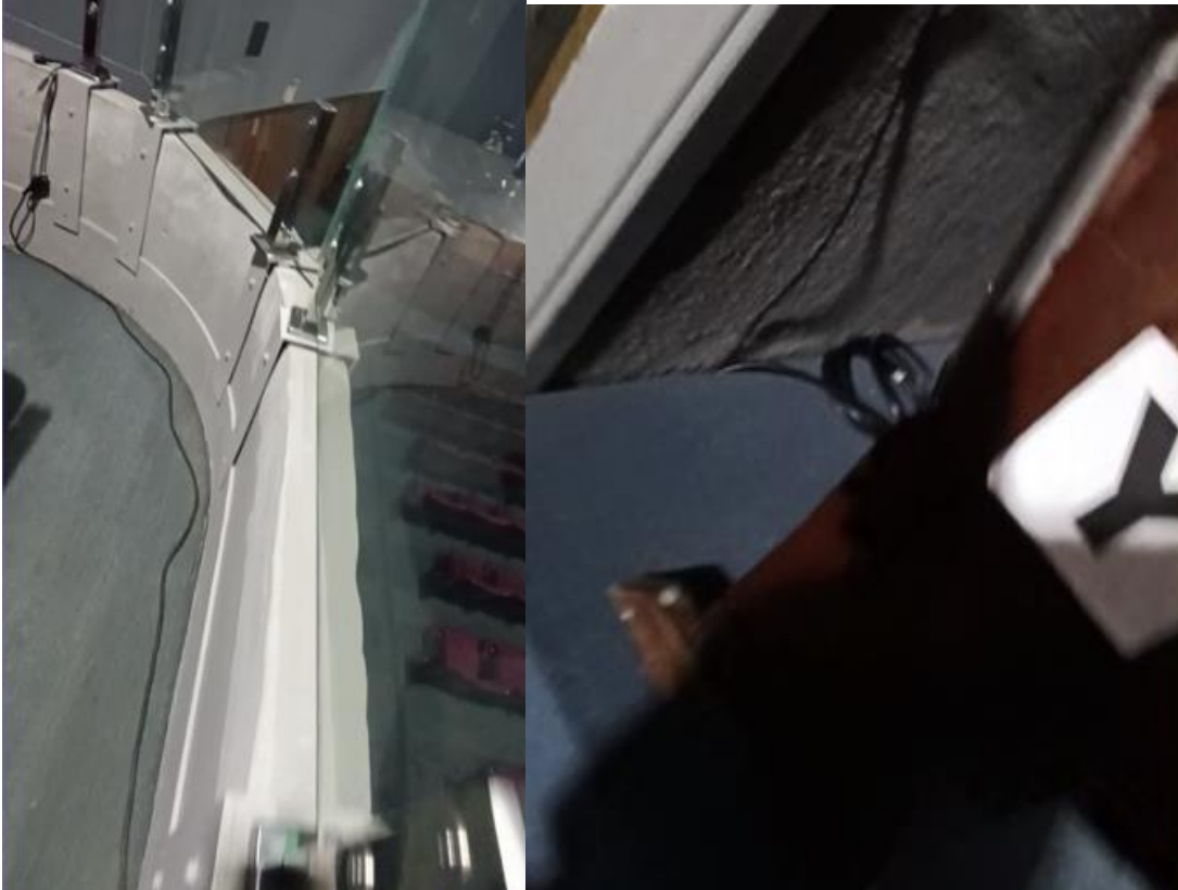
Fiação elétrica, emendas, tomadas e cabeamentos diversos “enrolados” no guarda corpo da platéia superior. Cabos passando por entre as poltronas sem eletocalha ou proteção para equipe de servidores, técnicos e público
