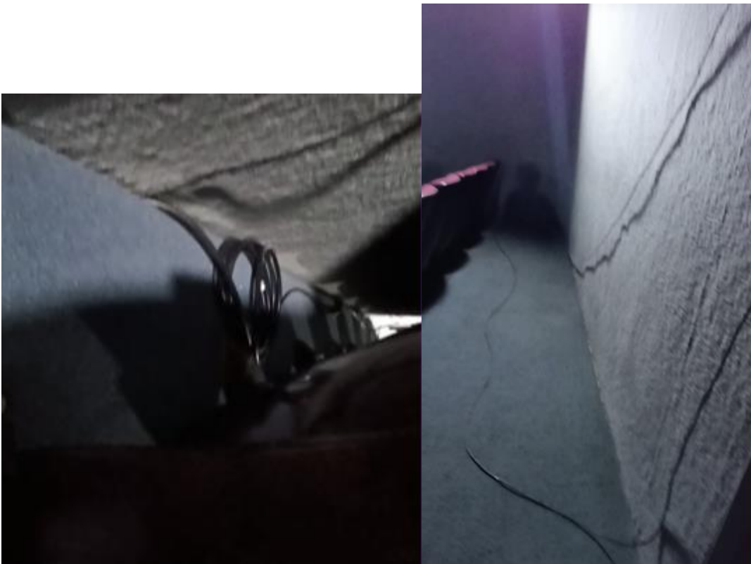
Fios elétricos caindo das paredes na platéia e passando por trás das poltronas, sobre o carpete
