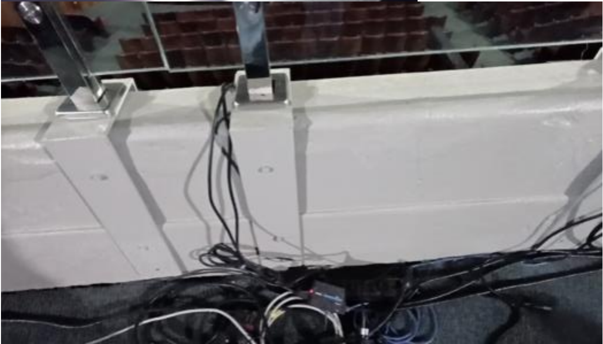
Fios espalhados na sacada da platéia superior. Indicação do local onde haviam goteiras e infiltração no forro de gesso.
